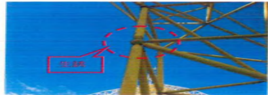
桁架接頭照片(10)
