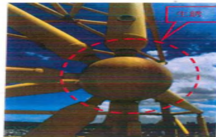
桁架接頭照片(12)
