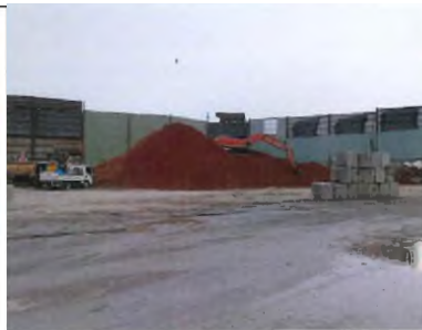
說明：現場堆置之逸散性粒狀污染物
