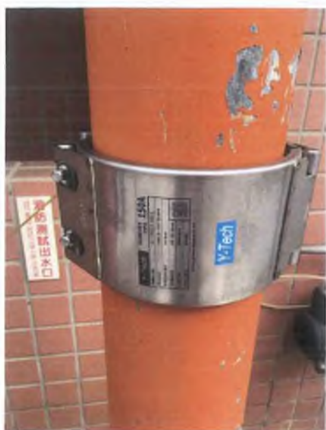
下圖：直管用止漏管夾，消防管線銹蝕 1" (點擊可放大)
